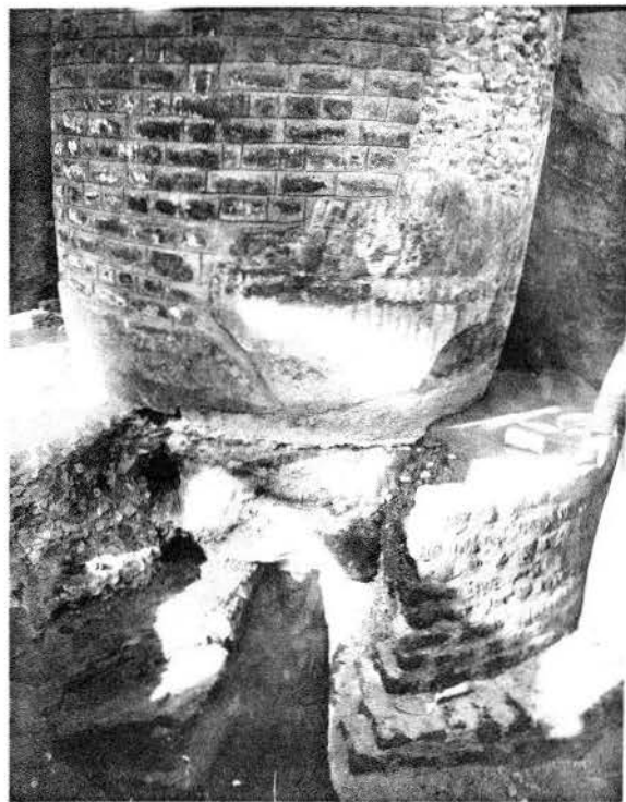
Fondation d'une des colonnes de la rangée nord de la Grande Cour.
