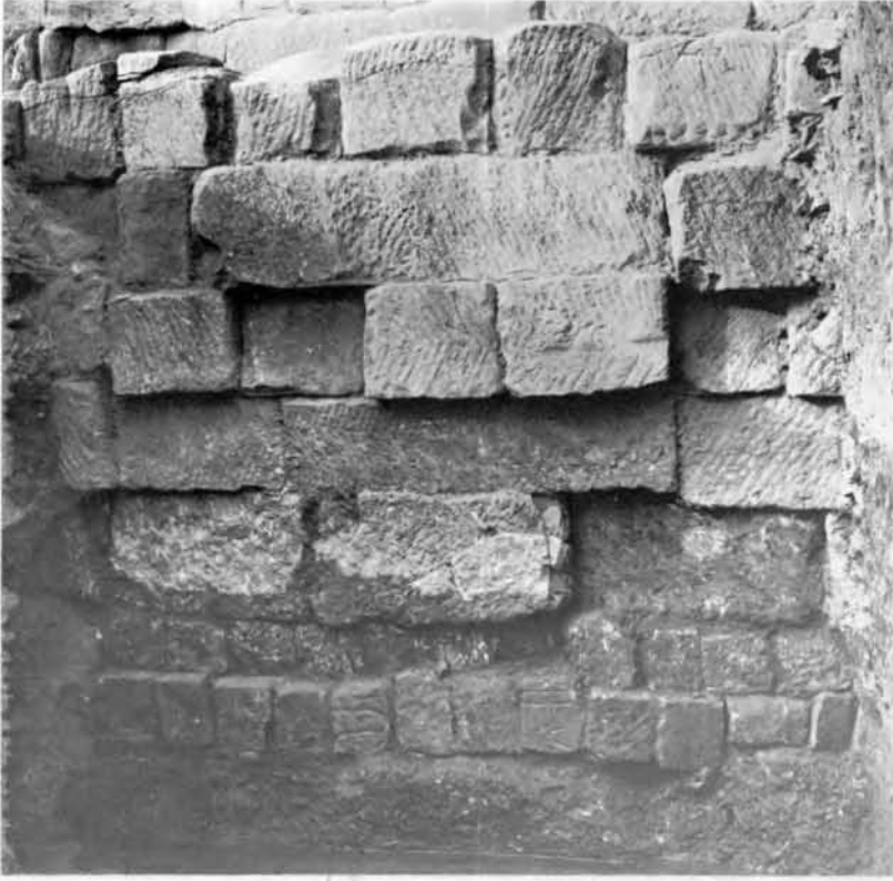
Pl. II/a. Sondage S2 : les quatre assises supérieures de la fondation sont faites de blocs de restauration antiques, aisément reconnaissables à leurs traces de taille obliques ou en chevrons. Cl. M. Azim.
