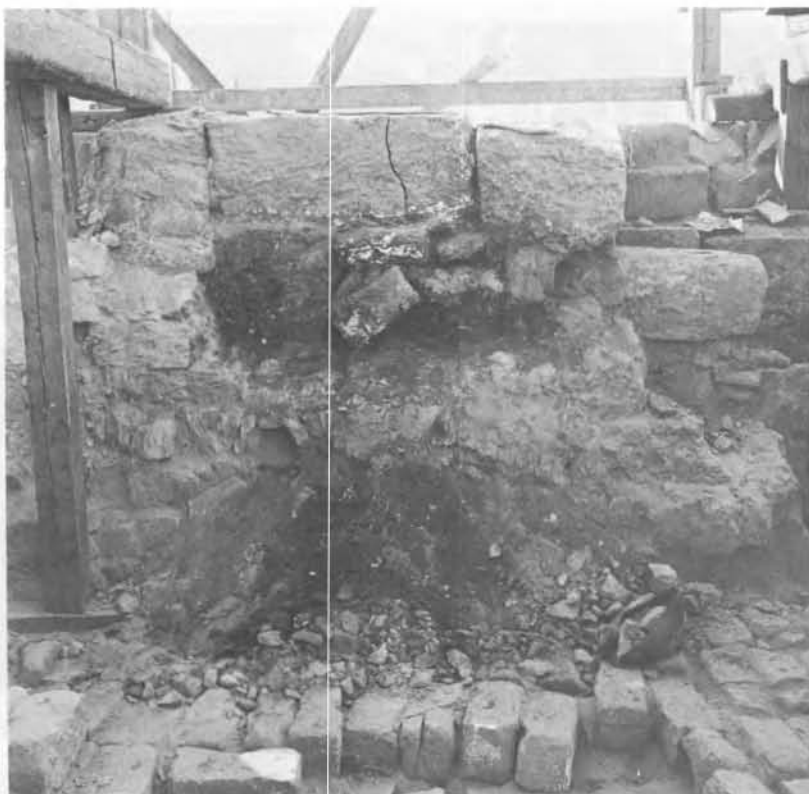
Pl. VIII/a. L'instabilité des blocs constituant les encoches de mât a imposé leur démontage ; ici, vue de l'encoche ouest depuis l'intérieur du pylône. Cl. M. Azim.
