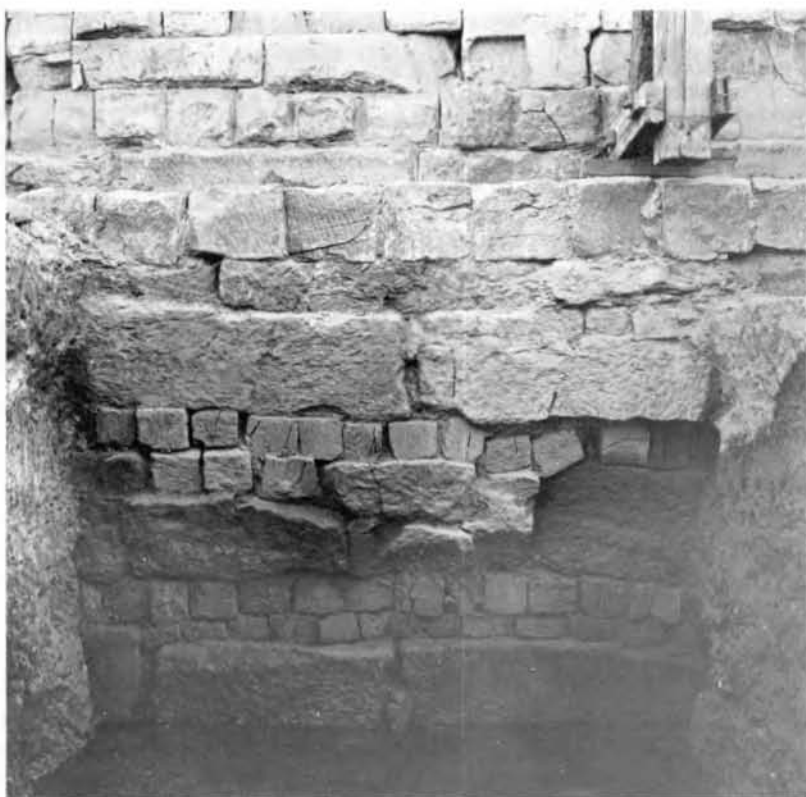
Pl. I/a. Fondations du IX e pylône dans le sondage S3 (face sud), mettant en évidence l'alternance des grands blocs et des talât placées en couches de répartition. Cl. M. Azim.
