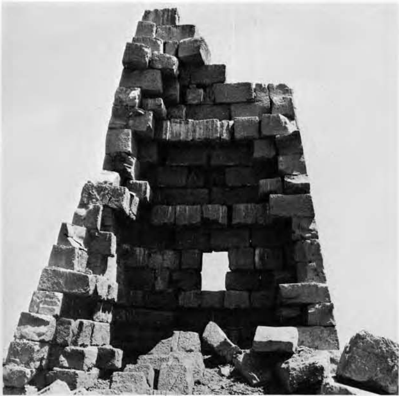
Pl. VI, a. La construction des parements du IX e pylône à son extrémité est. On notera en particulier les blocs en boutisse toutes les quatre assises. Cl. A. Bellod.
