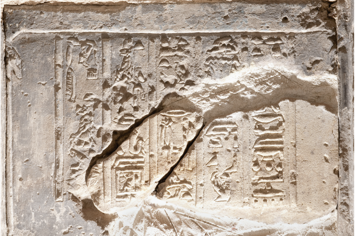
Fig. 19. Exemple de collage dans la niche du Naos. Les deux fragments ont été collés provisoirement à la résine époxy puis maintenus définitivement avec une maçonnerie de briques et de chaux. © Cnrs-Cfeetk/J.-Fr. Gout.
